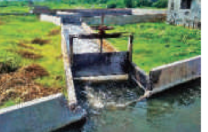
कपूर्थला के सीवरेज ट्रीटमेंट का पानी बिना ट्रीट किए काली बेई में छोड़ा जा रहा है। हालांकि एनजीटी ने रोक लगा रखी है, लेकिन नगर निगम कपूर्थला आंख मुंदे बैठा है। जागरण
