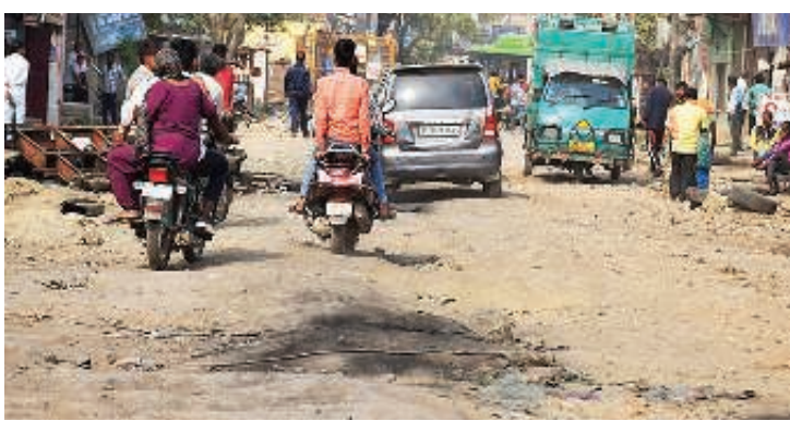
कराबल नगर में सड़क की जर्जर हालत।
